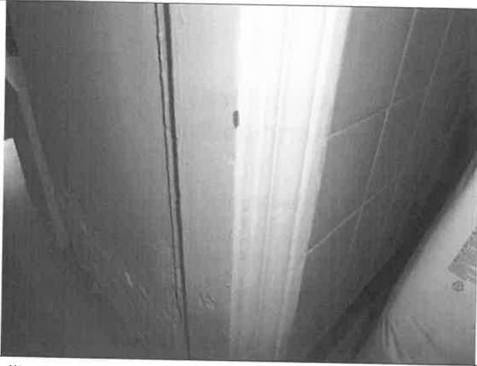
Illustration du bâti de porte de la Salle d'eau en zone B
