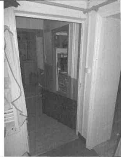
Illustration du bâti de porte de la Salle d'eau en zone A
