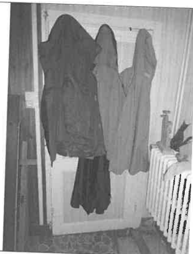
Illustration de la porte et bâti de porte de la pièce 1 en zone A
